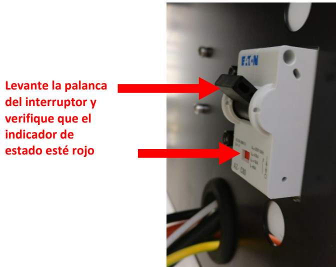
Figura 60 - Levantar la palanca del interruptor QB1
