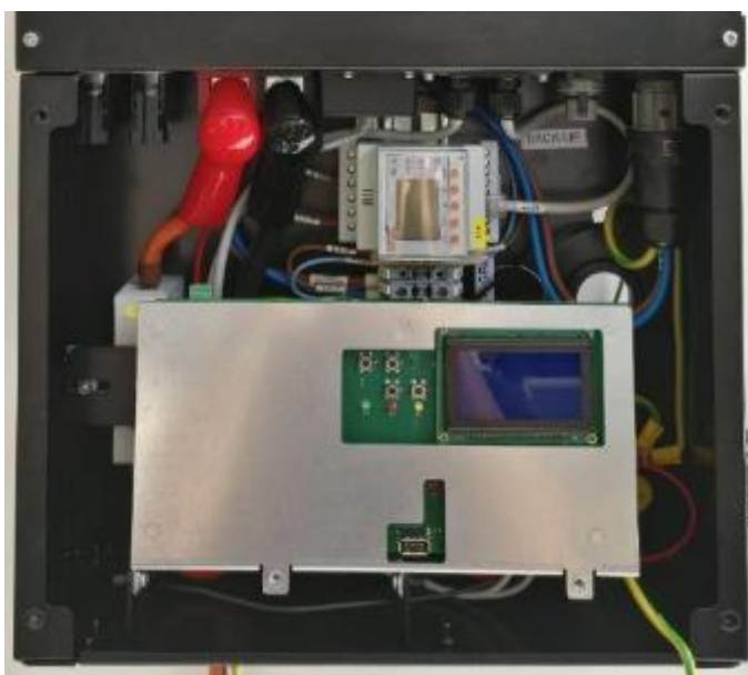
Figura 40 - Bloque de terminales ATM-BOX accesible
